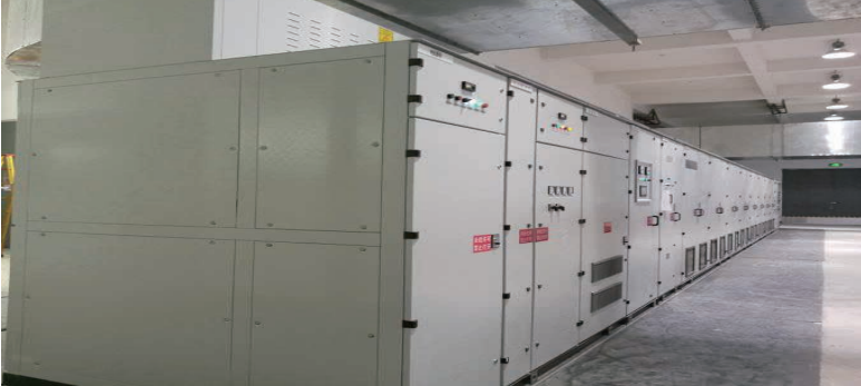
· 西气东输某压气站10000kvar
